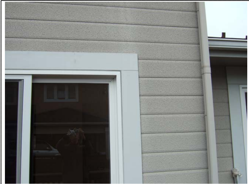
外壁サッシ周り.JPG
