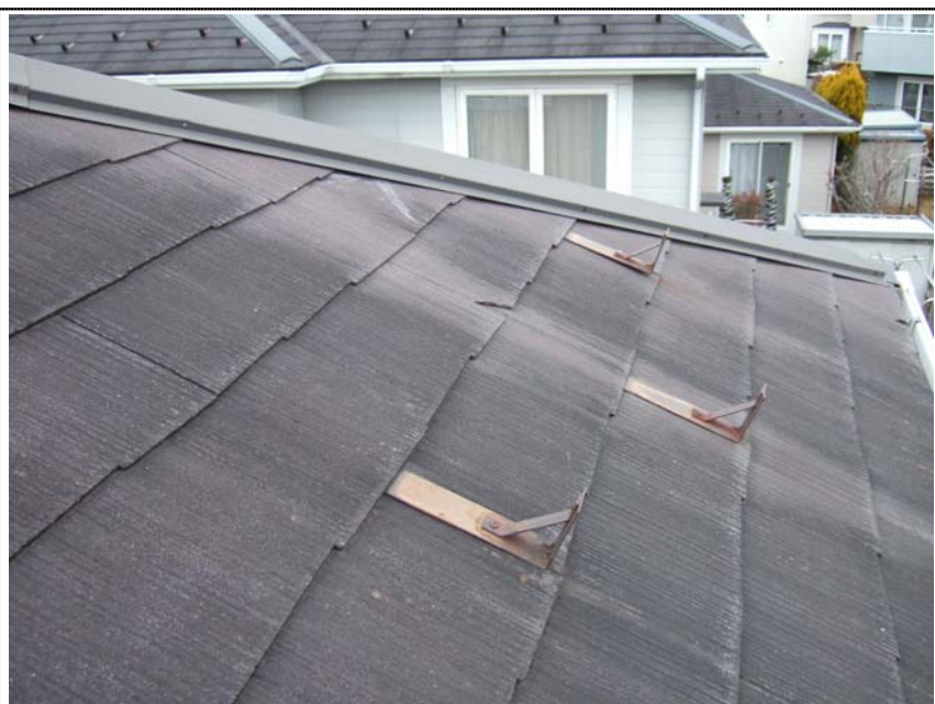
屋根東スレート破損.JPG
